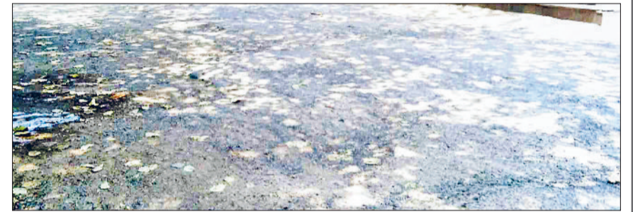
महेंद्रगढ़। गोशाला के पास जर्जर अवस्था में सड़क।
